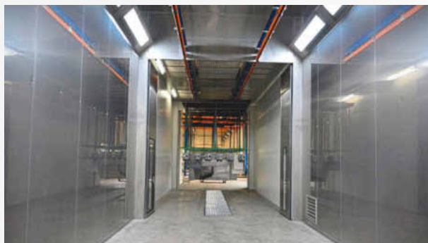
Die Waschkabine für die Hochdruckreinigung und im Anschluss der Haftwassertrockner. (Foto: M. Rehm)
