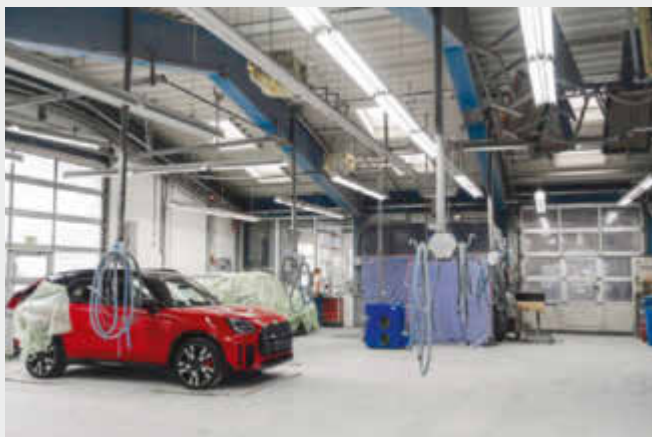
Zwei Hallen mit jeweils ca. 1.500 Kubikmetern werden heute mit je einem Puls-air Heizgerät beheizt.
